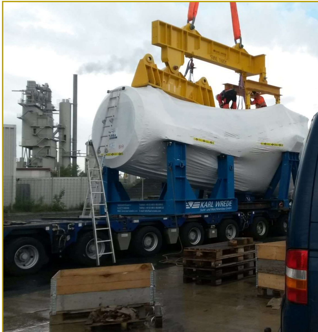
Traversenkombination Triebstrang 6 MW
